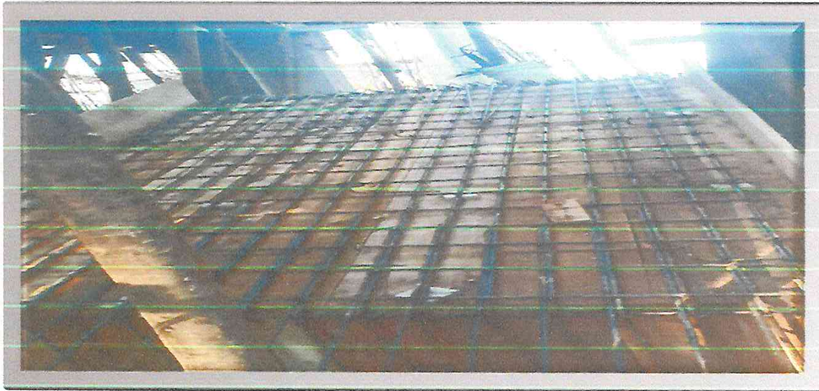
VISTA DE COLOCACION DE VARILLAS DE ACERO EN ESCALERA DE 1° PISO DE MOD "C"
